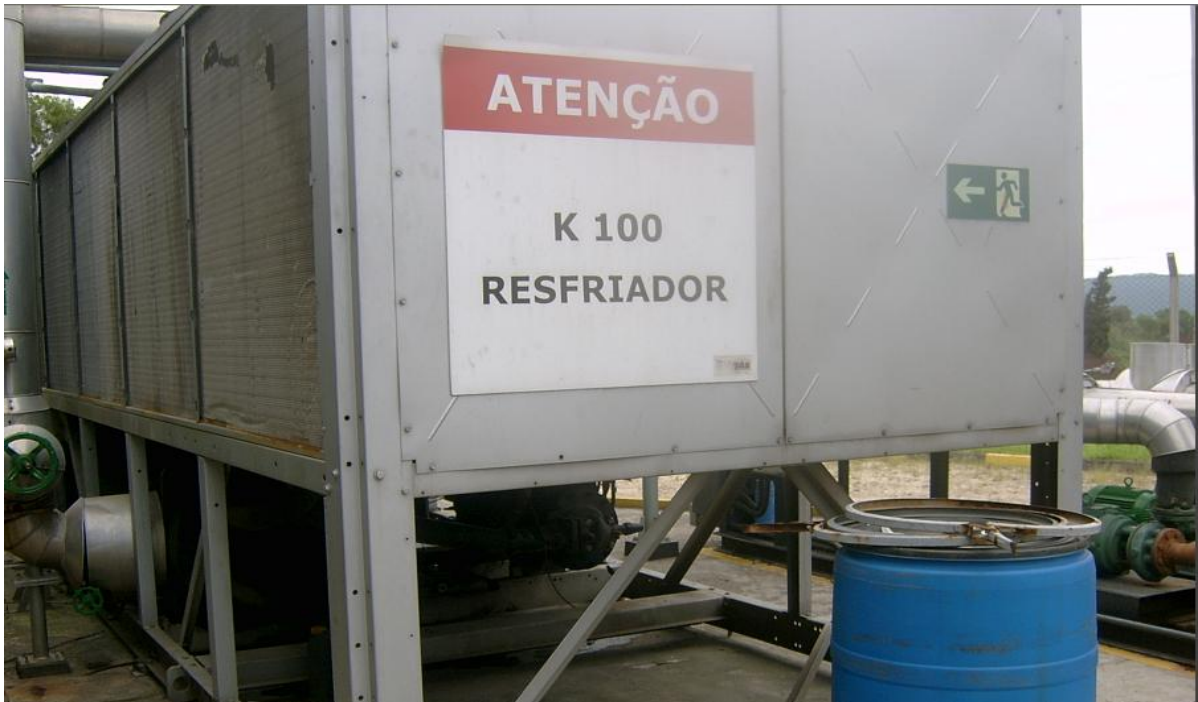
Figura 11 – Vista do resfriador para retirada do condensado após a etapa dos sopradores
