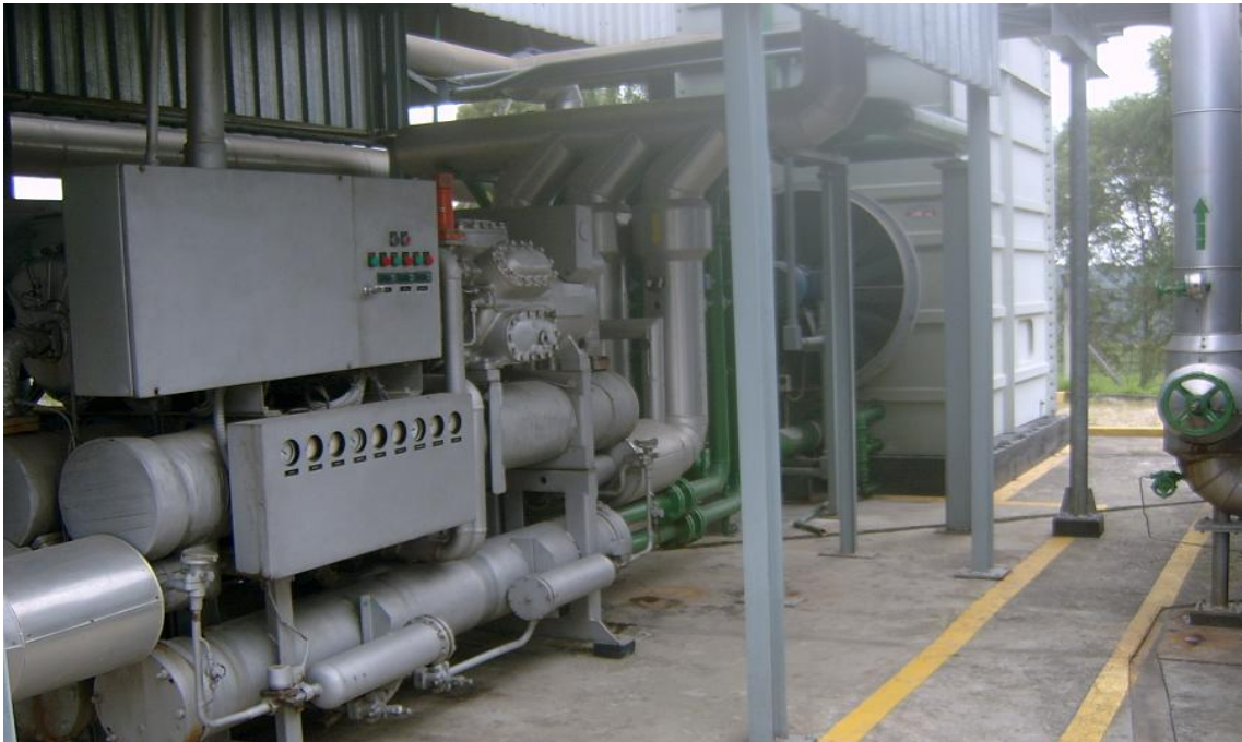
Figura 13 – Vista do motor de sucção, pré-pressão e ventiladores
