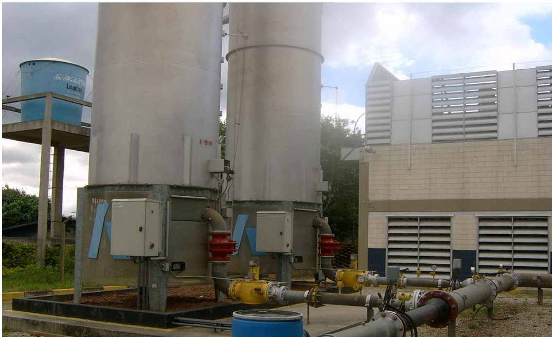
Figura 14 – Vista dos dois flares
