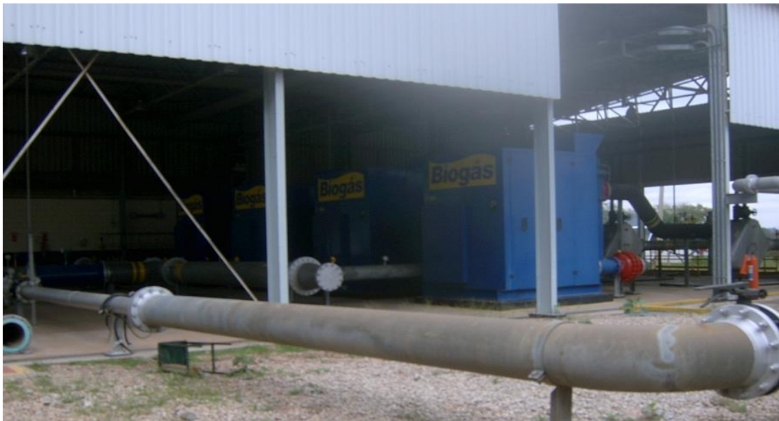
Figura 10 – Vista dos 4 sopradores após a etapa dos trocadores de calor
