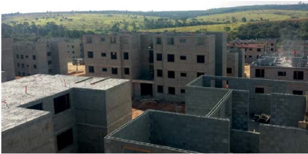
Figura 6 – Vista geral da obra do empreendimento Altos de Ipanema em andamento; ao fundo, lotes vizinhos rurais
