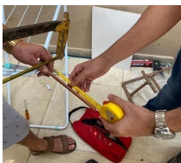
Figura 24 - Cortes dos tubos de cobre
